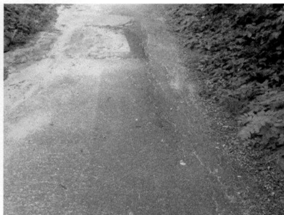
Zapadnięta jezdnia ul. Wąskiej
