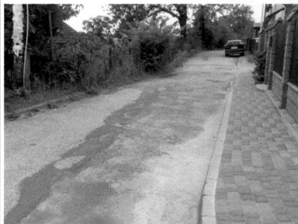
Uszkodzona jezdnia ul. Wąskiej
